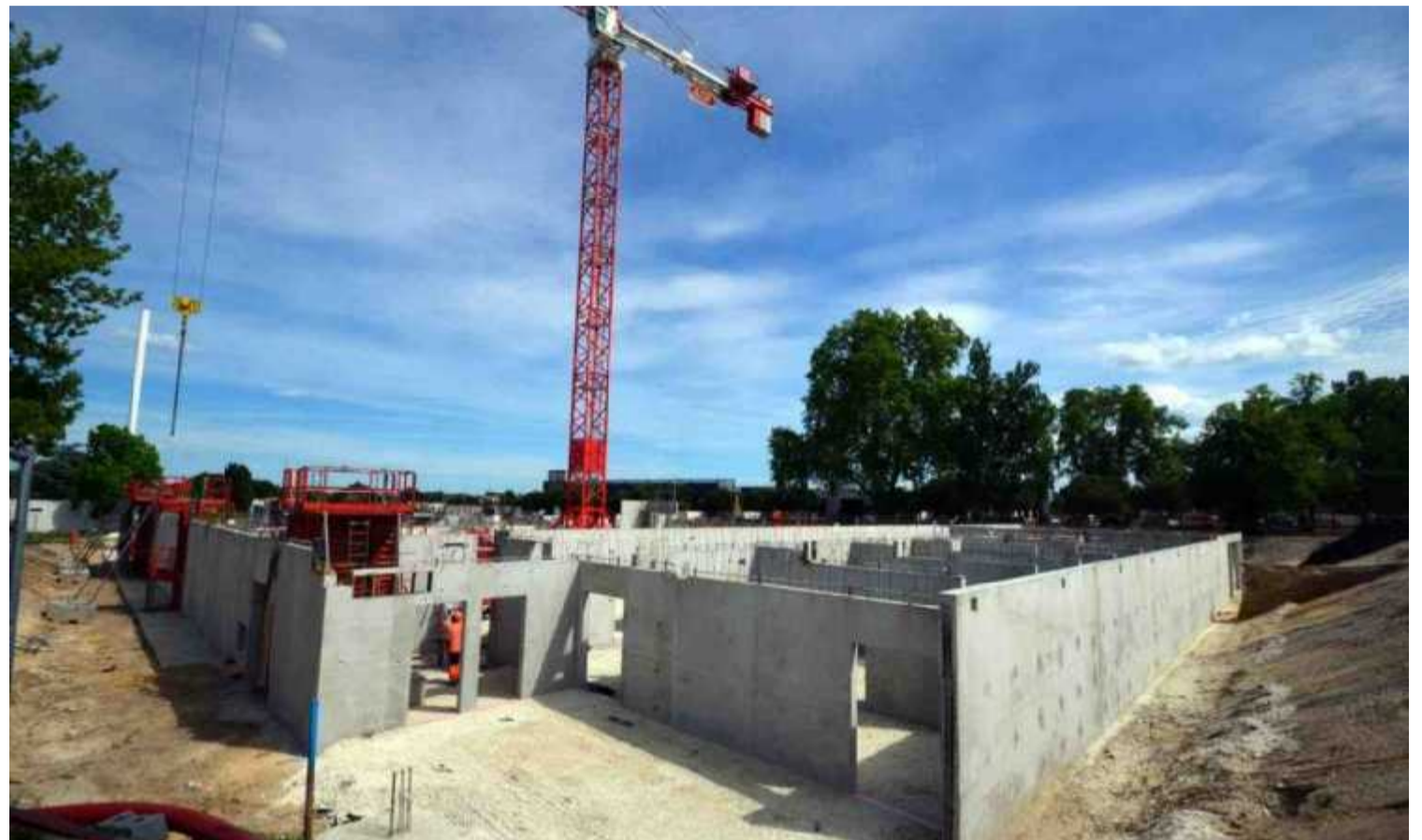
Le chantier du complexe sportif de Bellegrave dont les premiers éléments seront livrés cet été. PHOTO W.D.
